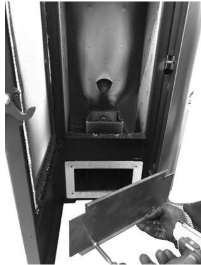
Fig. 31 - Den Inspektionsstopfen entfernen
